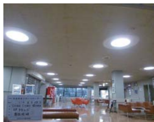
安佐南区スポーツセンターロビーのLED照明
